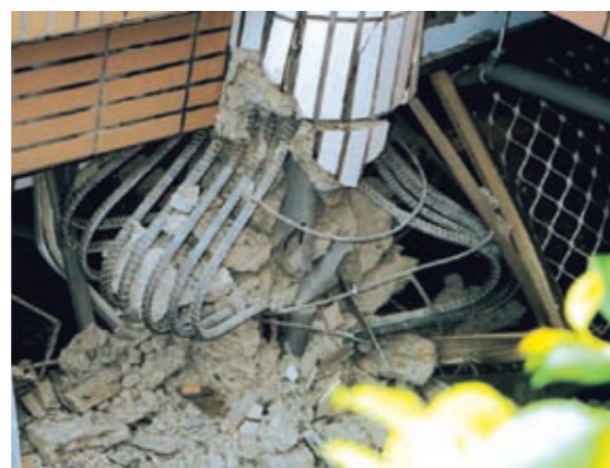
柱筋圍束施工不良，造成主筋爆開成燈籠狀
