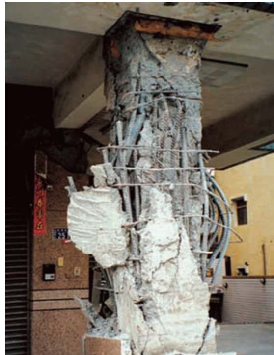
柱箍筋施工品質不良，造成破壞
